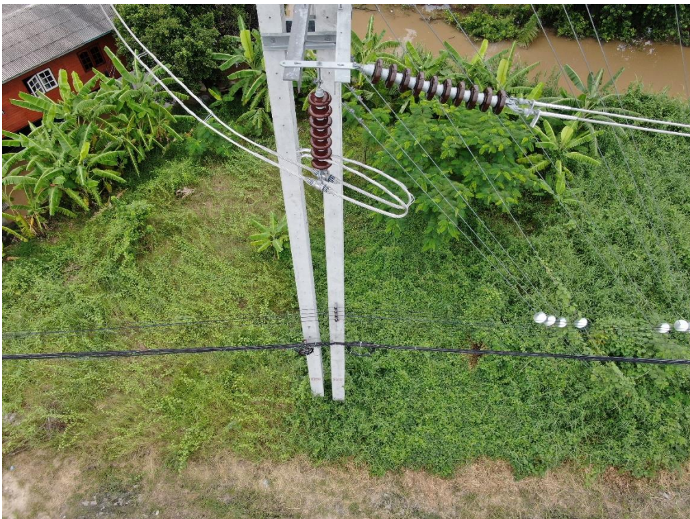
รูปที่ 10 ตัวอย่างภาพโครงสร้างเสา (concrete pole body)
