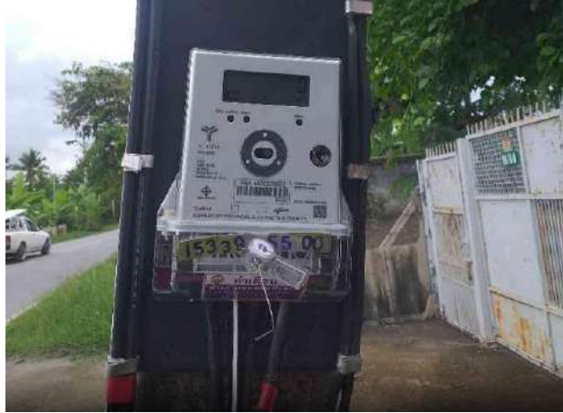
ตัวอย่าง รูปมิเตอร์ที่ติดตั้งโดยให้เห็นหมายเลขพีอีเอ, Security Seal และ Marking แสดงสายไฟฟ้าด้านเฟส
