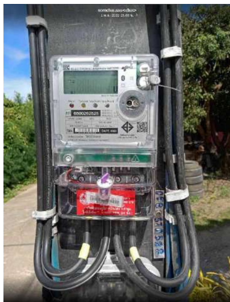
ตัวอย่าง รูปมิเตอร์ที่ติดตั้งโดยให้เห็นหมายเลขพีอีเอ, Security Seal และ Marking แสดงสายไฟฟ้าด้านเฟส
