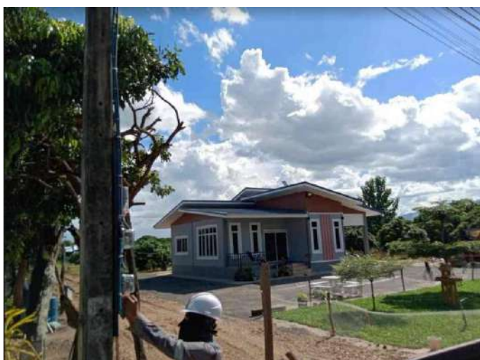
ตัวอย่าง รูปสถานที่ที่ติดตั้งมิเตอร์
