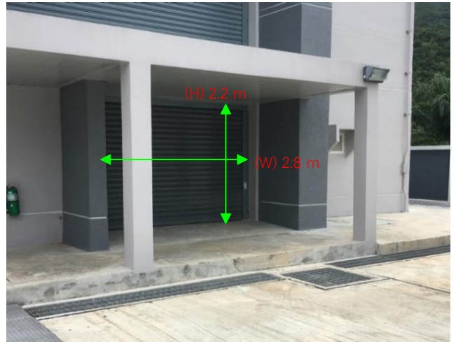
(1) ประตูเลื่อนทางเข้า : ฝั่งด้านนอก, ผู้ขายต้องเตรียมทาลาดสำหรับเคลื่อนย้ายพัสดุเข้าห้อง Cable Room
