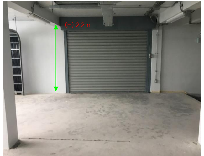
(1) ประตูเลื่อนทางเข้า : ฝั่งด้านใน Cable Room, ความสูงประมาณ 2.2 เมตร
