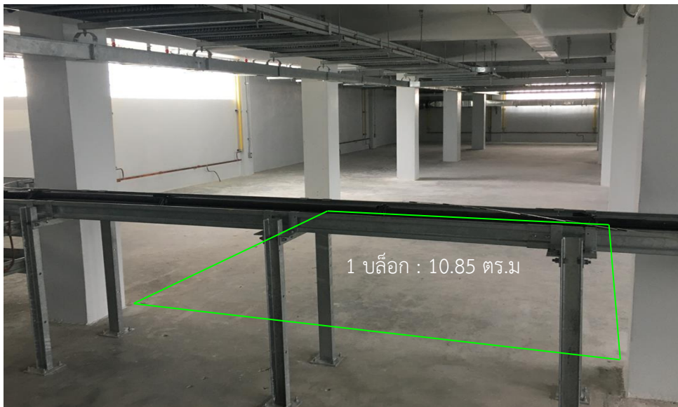
(5) บริเวณพื้นที่ว่างสำหรับจัดเก็บพัสดุ : ขนาด 10.85 ตร.ม/บล็อก จำนวน 10 บล็อก
