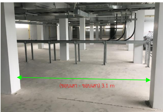
(2) ระยะขอบเสา-ขอบเสา (แนวเหนือ-ใต้) : 3.1 เมตร
