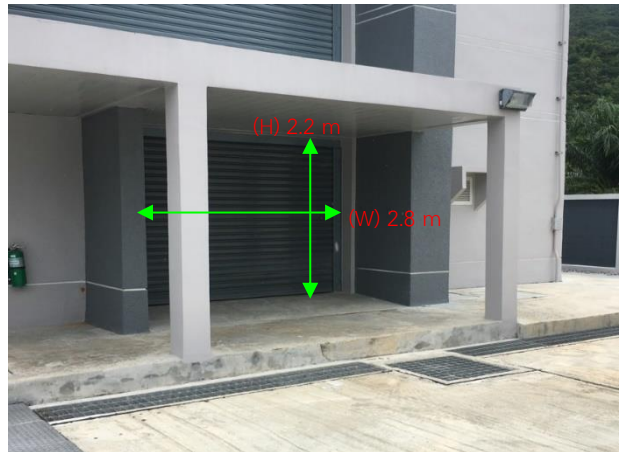
(1) ประตูเลื่อนทางเข้า : ฝั่งด้านนอก, ผู้ขายต้องเตรียมทางลาดสำหรับเคลื่อนย้ายพัสดุเข้าห้อง Cable Room
