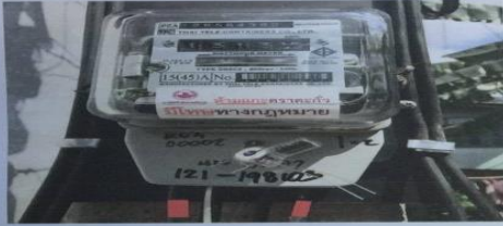
กรณี มิเตอร์ติดตั้ง เฟส A (สีแดง)
